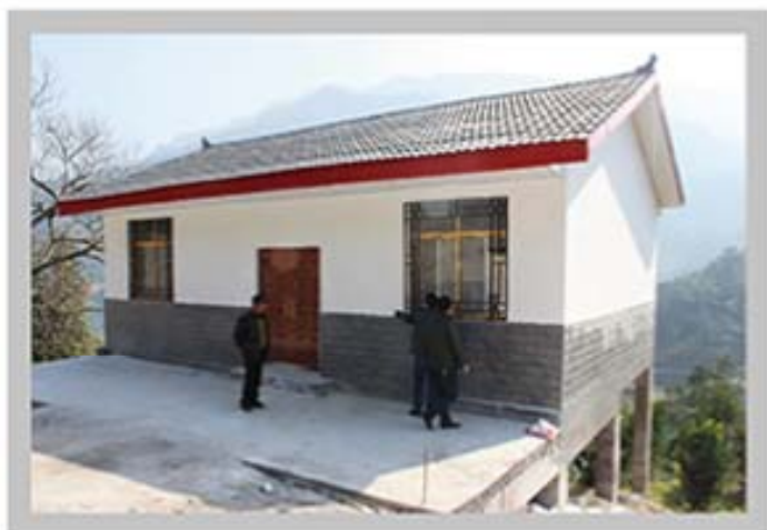
桑植县大溪乡张家桥村卫生室已完成主体施工，正在进行内部装修。
